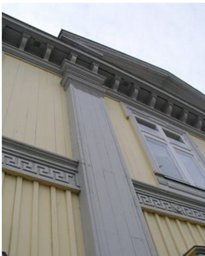
Stående lockläckt och slät panel på byggnadens fasad mot Rådhusorget © Falken PM.
